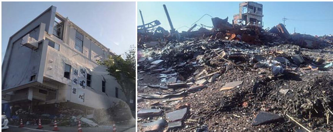
倒壊建物、輪島朝市消失。そのままの状態
